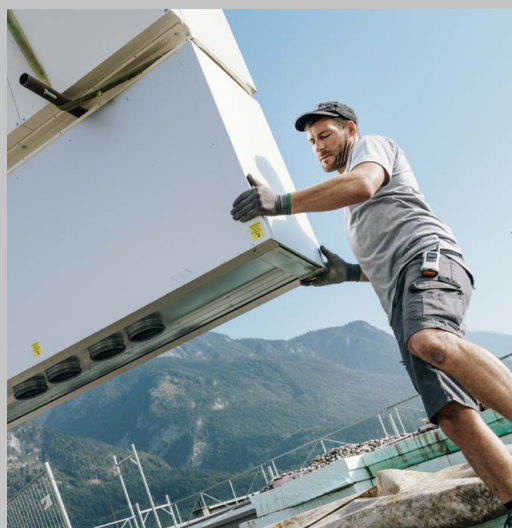
... drei zentrale Lüftungsgeräte installiert.
