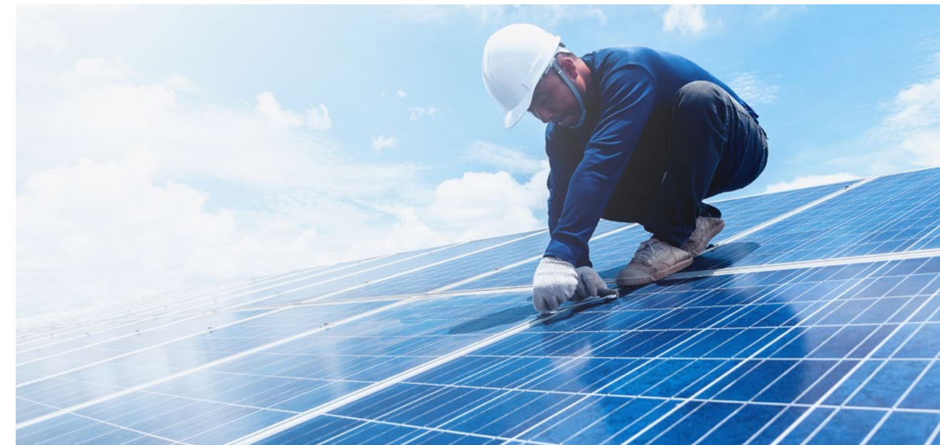
Highlight der Wohnanlage ist die groß dimensionierte PV-Anlage für die ausgeglichene Energie-Jahresbilanz
